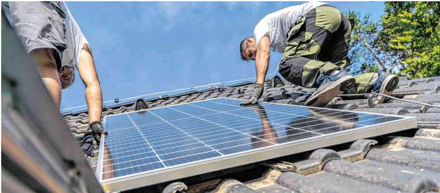
Wenn eine Photovoltaikanlage fachgerecht installiert wird, besteht geringe Brandgefahr.
